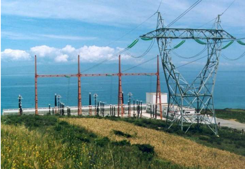
Interconnexion électrique Maroc- Espagne
